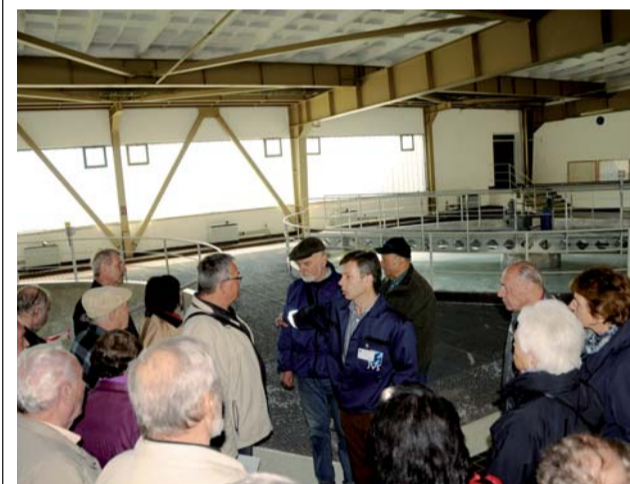
Jedna z prvních zastávek byla v budově dávkování chemikálií
