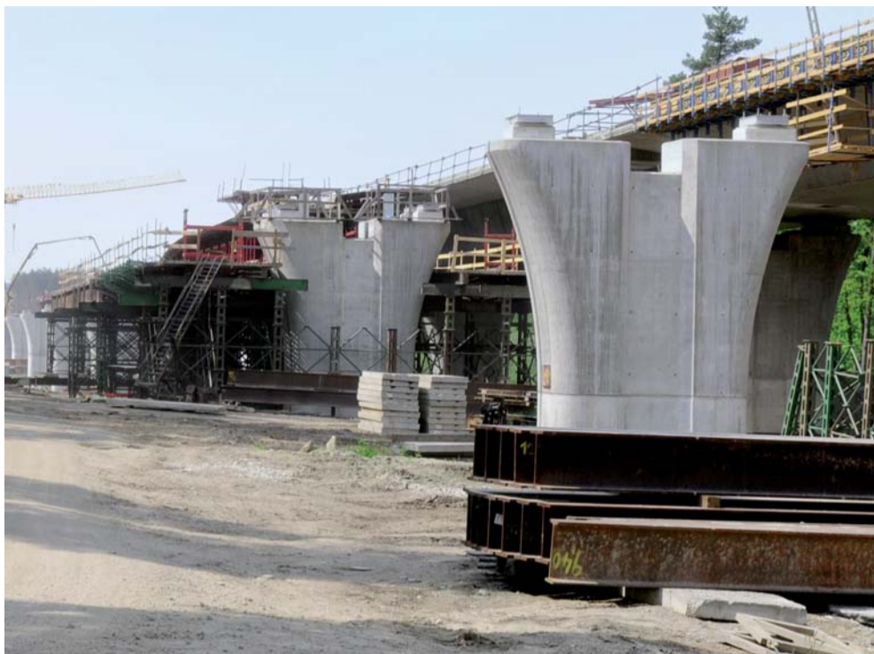
V místech, kde vede nová dálnice přes dálkový vodárenský řad, se muselo potrubí překládat
