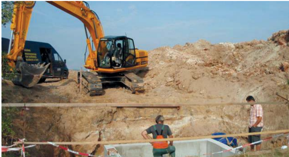
Jednou z nejvýznamnějších loňských investic bylo napojení Lomnice nad Lužnicí a okolních obcí na Jihočeskou vodárenskou soustavu. Snímek je z výstavby. Více informací přinášíme na straně 3.
