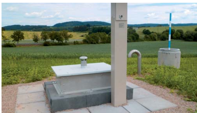
Předávací šachta vodárenské soustavy, napojení na Sarplast DN 400.
