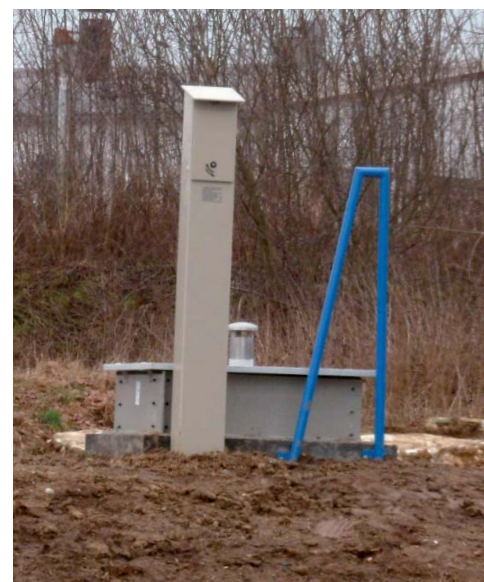
Předávací šachta pro vodojem Radomyšle.
