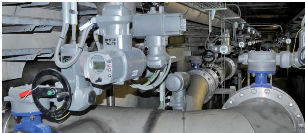
Armaturní vystrojení GAU filtrů.
