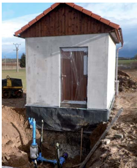
Čerpací stanice Osek se zemním armaturním uzlem.
