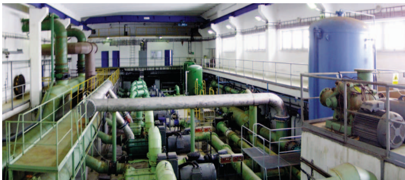
Jednou z významných letošních investic je výměna čerpadel a potrubí v čerpací stanici Hlavatce. Na snímku stav před modernizací.
